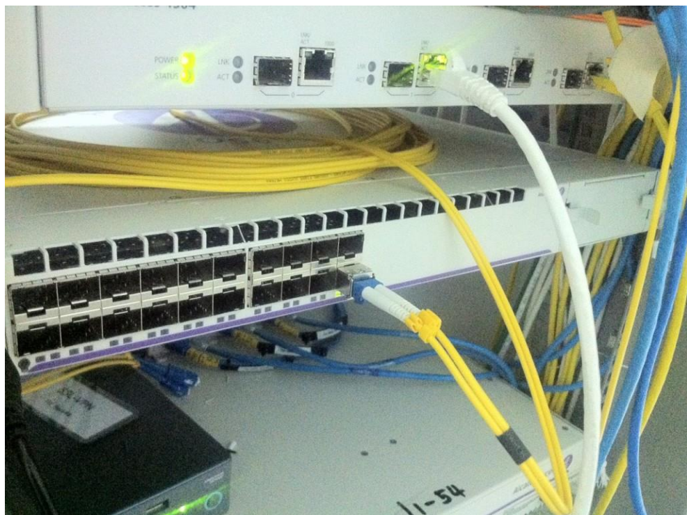
เปลี่ยน Distribute Switch ณ ศูนย์เทเวศร์
