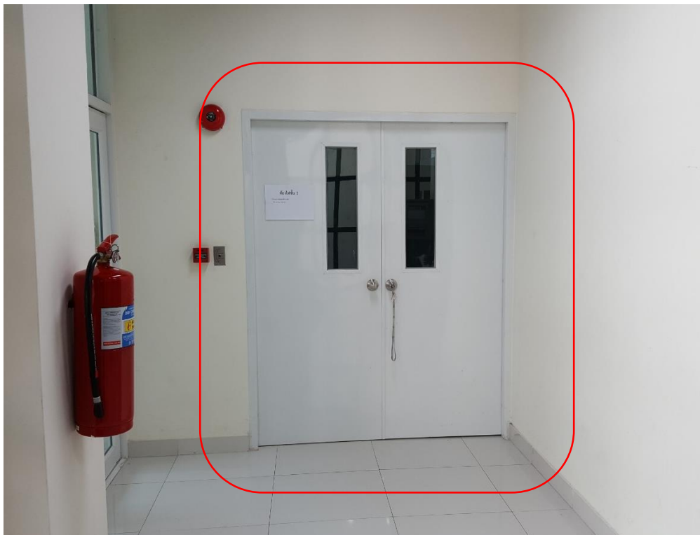
ในห้องไฟฟ้าหลังลิฟท์
