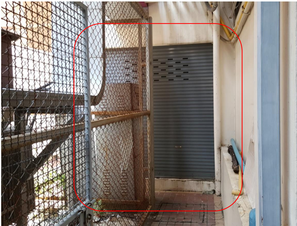
ในห้องไฟฟ้าด้านหลังอาคาร
