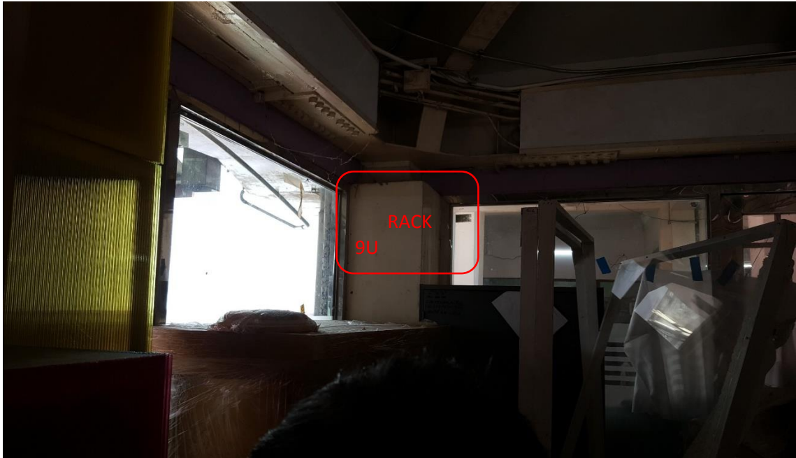
Rack 9 U XXX-DF01-SW05 เสาปูนด้านข้างเวที
