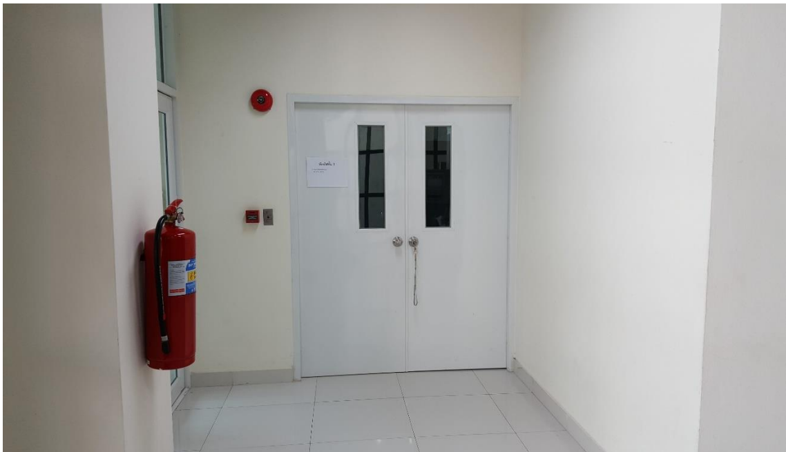
ในห้องไฟฟ้าหลังลิฟท์
