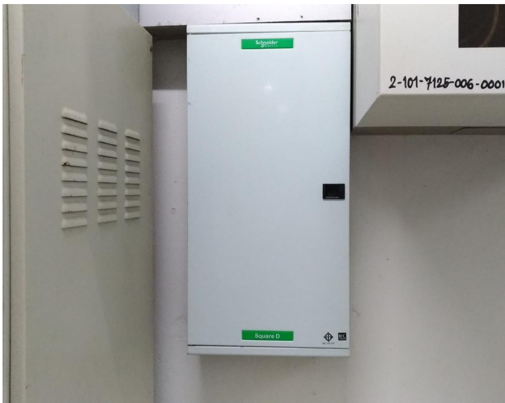
ตู้ไฟฟ้าข้างบันได
