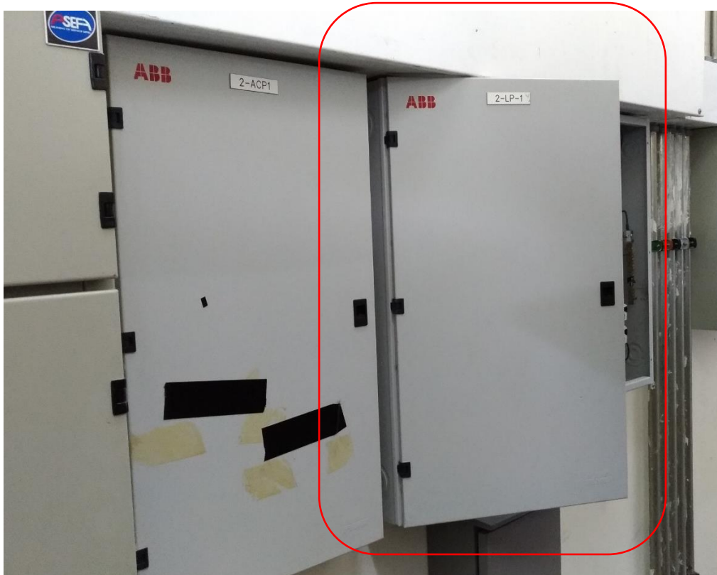
ในห้องไฟฟ้า
