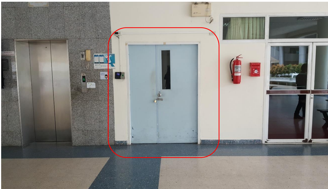
ในห้องไฟฟ้าข้างลิฟต์
