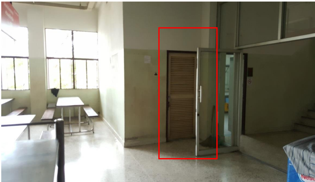
ในห้องควบคุมไฟฟ้า ชั้น2
