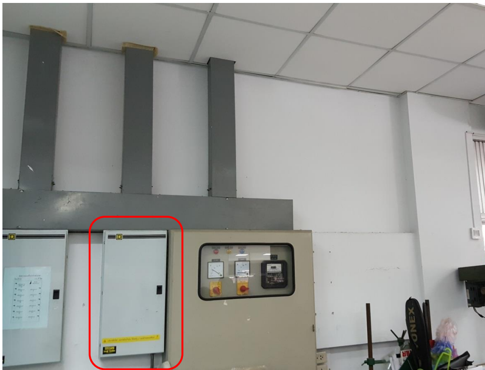
ตู้ไฟฟ้าในห้องอาจารย์
