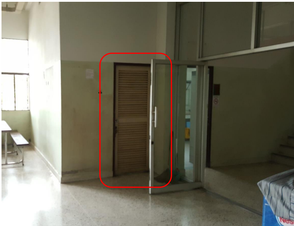
ห้องไฟชั้น2
