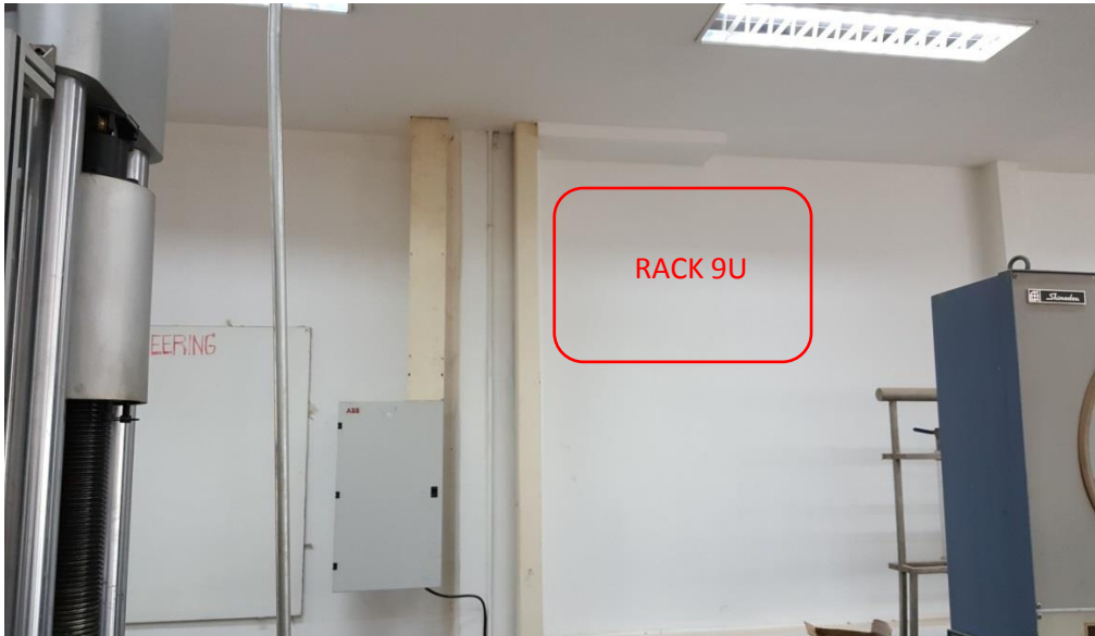
Rack 9 U XXX-IF01-SW07 บริเวณห้องผสมดินด้านหลัง
